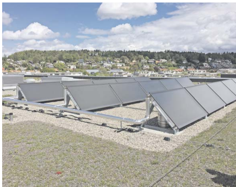
Diese Solaranlage auf dem Schulhaus Chrüzacher wird für die Warmwasseraufbereitung genutzt.
