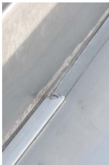
Fehlende Abschlusselemente sind gefährlich.
