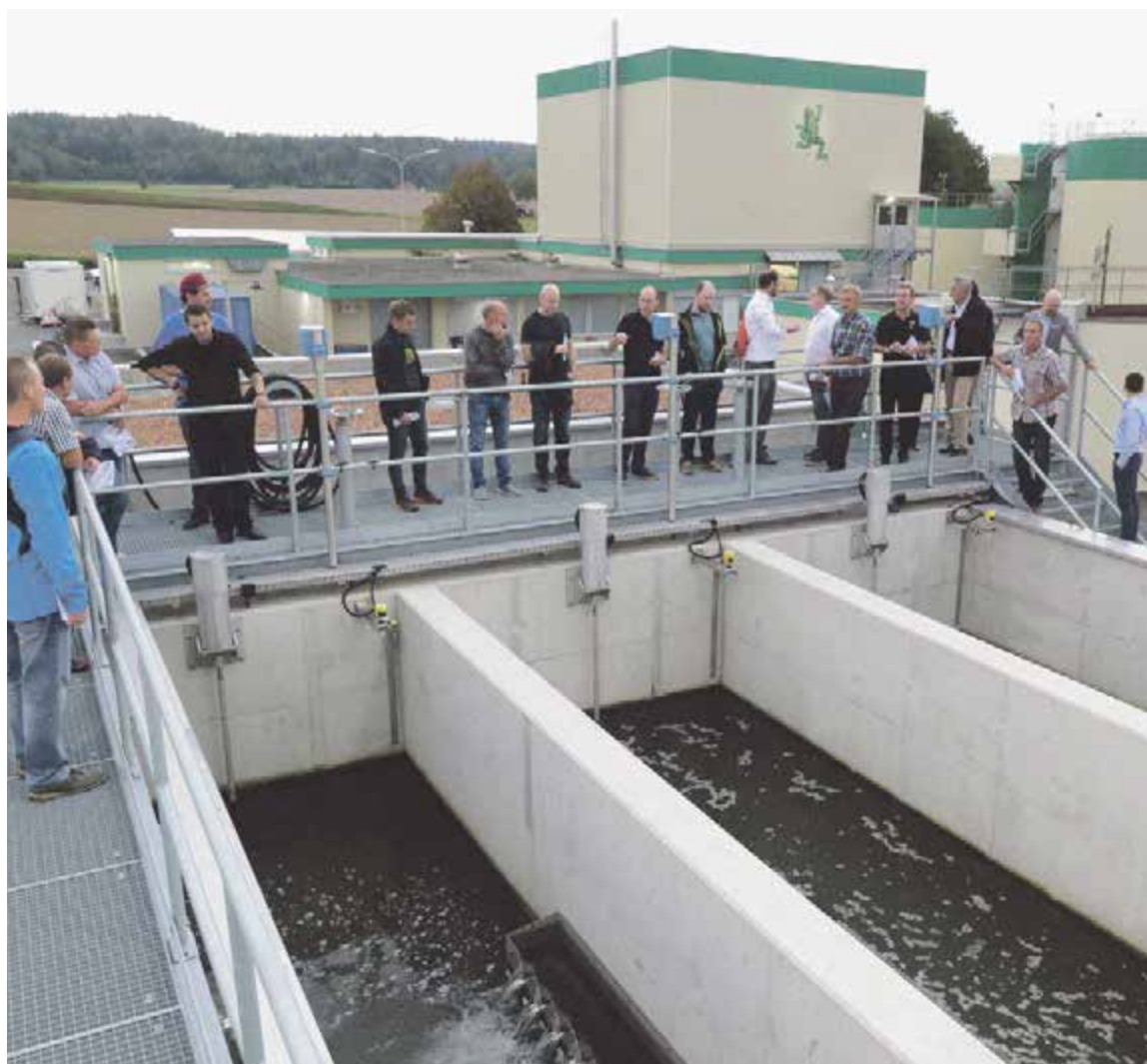
Die Quarzsandbecken der neuen Ozonungsanlage befinden sich auf dem Dach des neuen Gebäudes.
