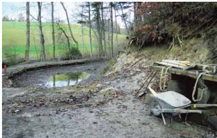
Der Müliweiher, wie er sich zu Beginn der Arbeiten zeigte: Das Wasser wurde abgelassen, die Geräte stehen bereit. (cw)
