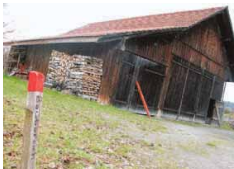
Der Schopf steht im Baubereich und muss weg. Durch eine Verlegung würde er den Oberwilern aber erhalten bleiben. (uw)
